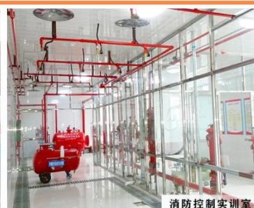
消防控制实训室
